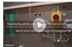
Raumluftqualität und effiziente Klimatisierung durch eine Lüftungsanlage
